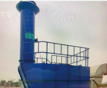
LGDYT（烟台）废气处理设施
