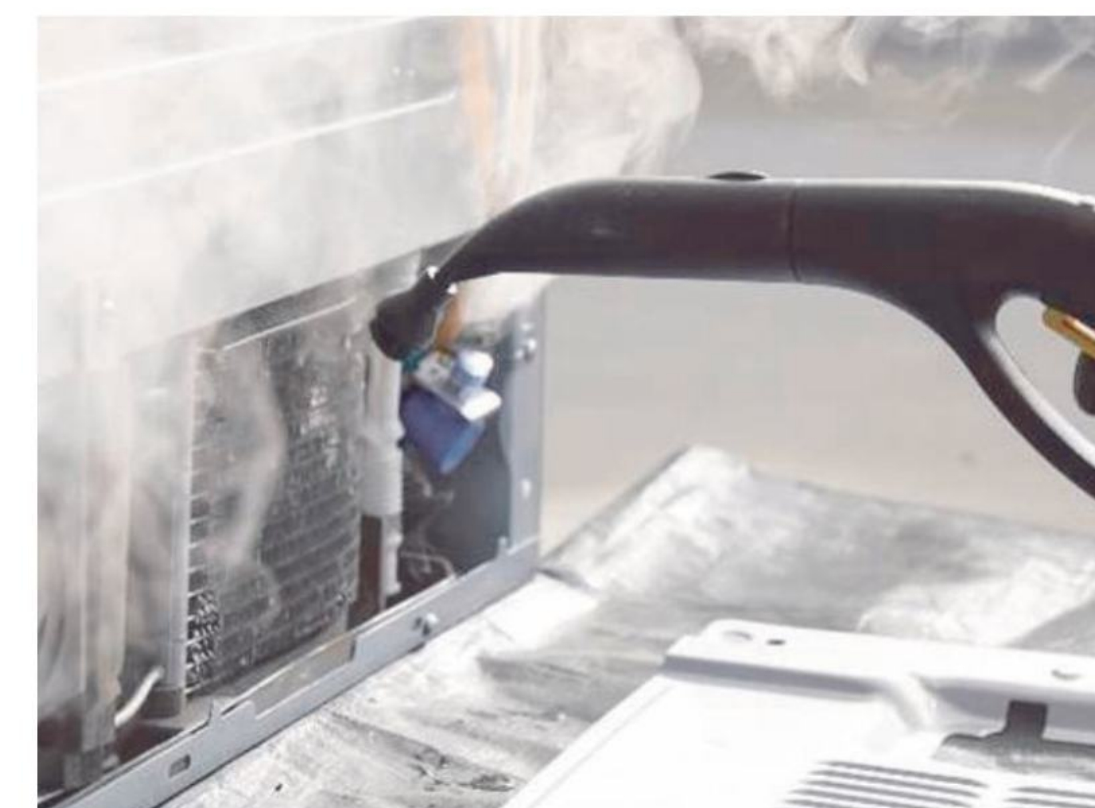
蒸氣清潔冷凝器
